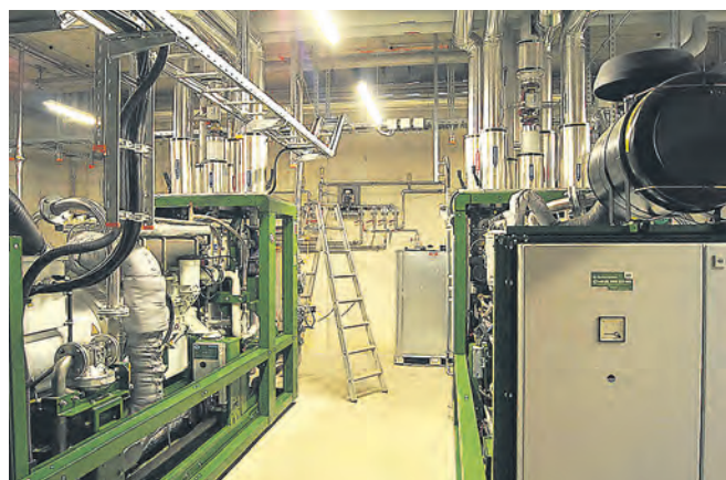
Blick in die Blockheizkraftwerke
