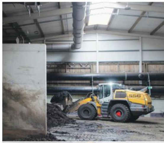
Nach einem ersten Schritt der Verkleinerung landet der gesammelte Bioabfall in der grossen Rangierhalle.
