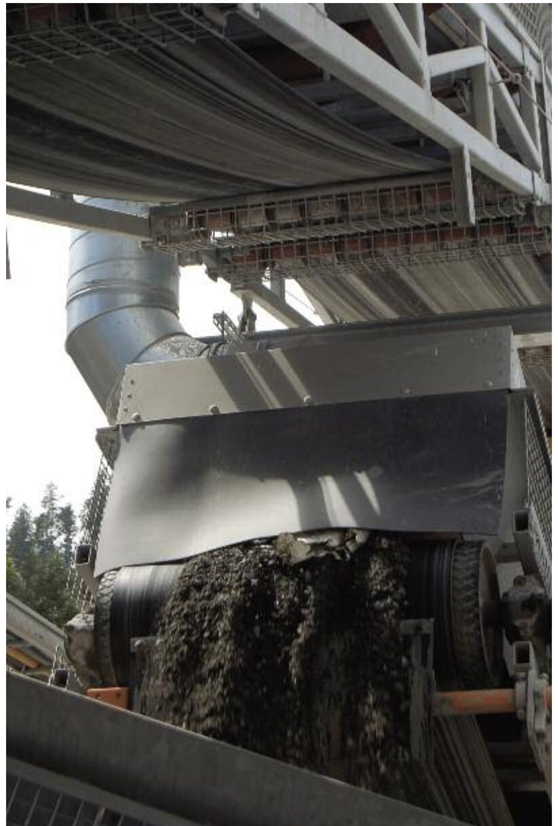
Die neue Metallentschrottungsanlage im Betrieb.
